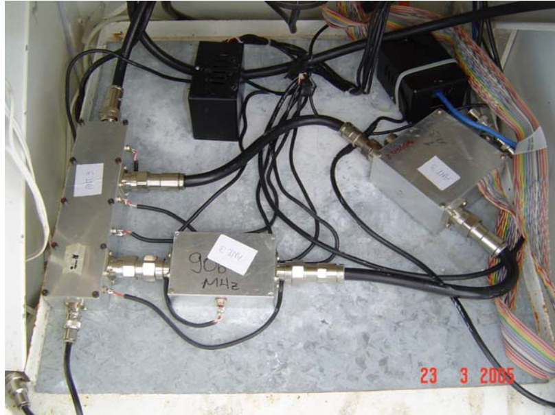
FIGURA 4.3 – Foto do receptor (entrada 1,6 GHz e saída 70 MHz) instalado na torre da antena.
