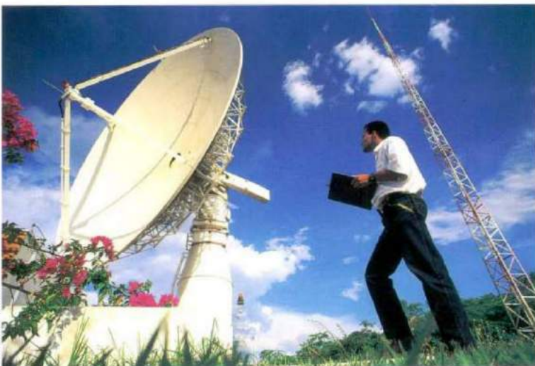
Antena de recepção dos dados do SCD-1 instalada no INPE, em Cuiabá, MT. Data reception antenna for the SCD-1 satellite, installed at INPE, Cuiabá, in the state of Mato Grosso.
