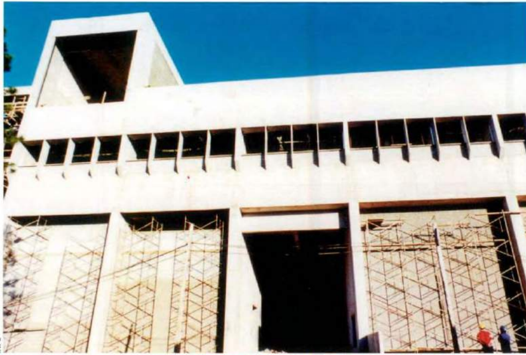
Obras do Laboratório de Integração e testes, em 1986. The Integration and Tests Laboratory, LIT, under construction in 1986.
