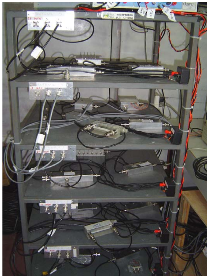
FIGURA 4.4 – Foto dos 5 receptores, entrada de 70 MHz e saída banda base de 2,5 MHz (seno e co-seno), instalados no rack dentro do container operacional.
